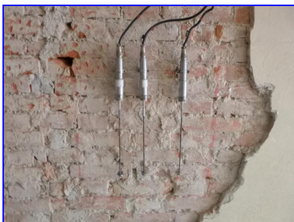
Foto 22: Sensori installati per il carico d'esercizio
